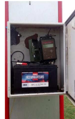
Figure 288 : SM4BAT et sa batterie installés dans un caisson de protection en bas du mât de mesure (G. Marchais, Écosphère)
